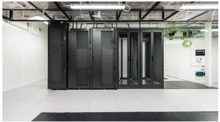
Dentro del módulo prefabricado Vertiv
